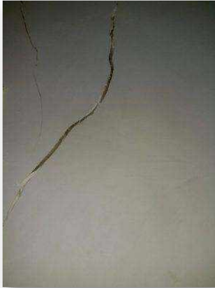
ترک قائم و مورب دیوار به علت نشست
