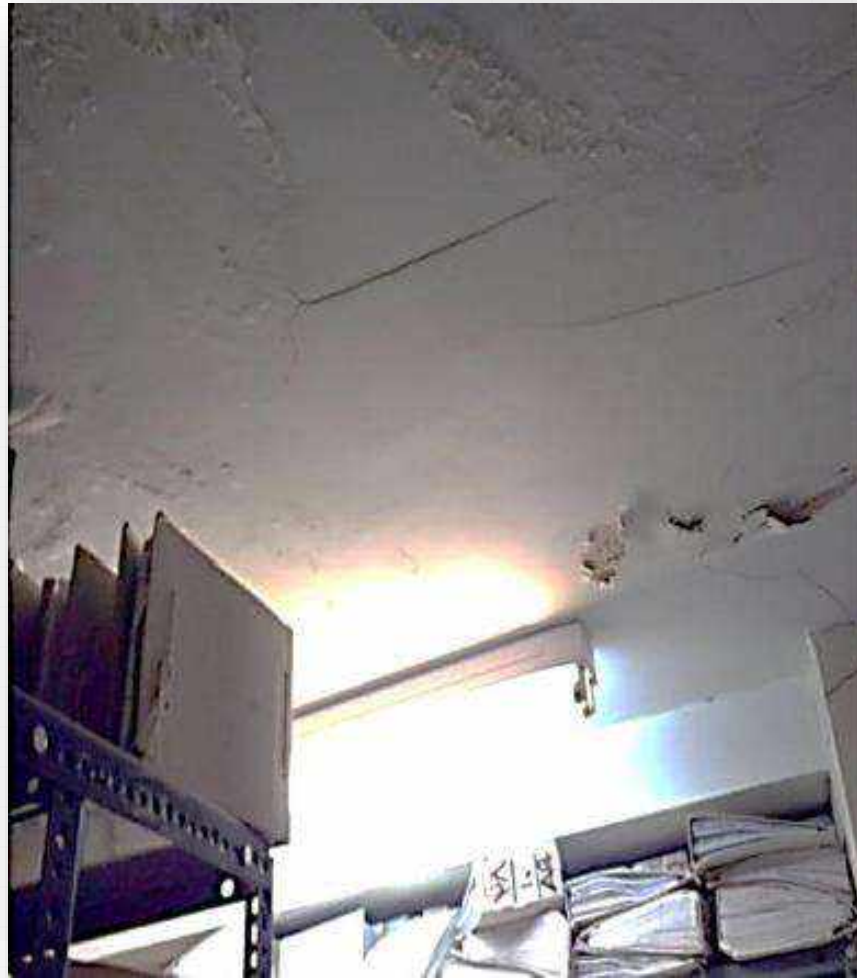
ترک ناشی از رطوبت و نم
